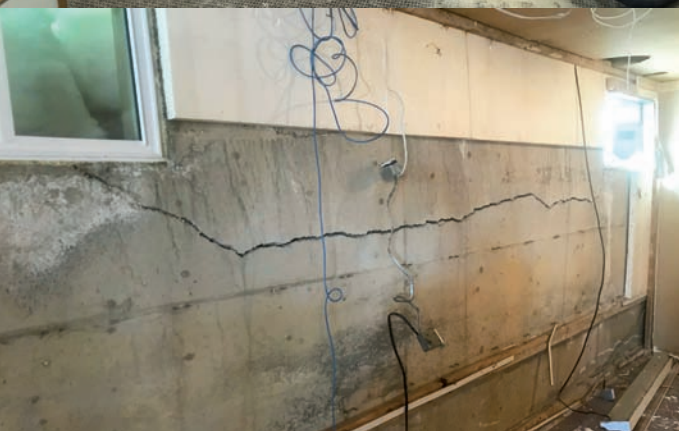
Mur de béton fissuré à reconstruire.
